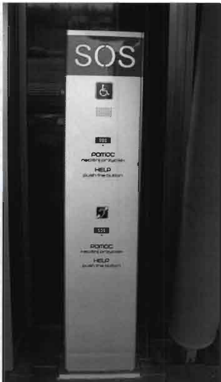
Panel powiadamiający SOS przed terminalem pasażerskim
